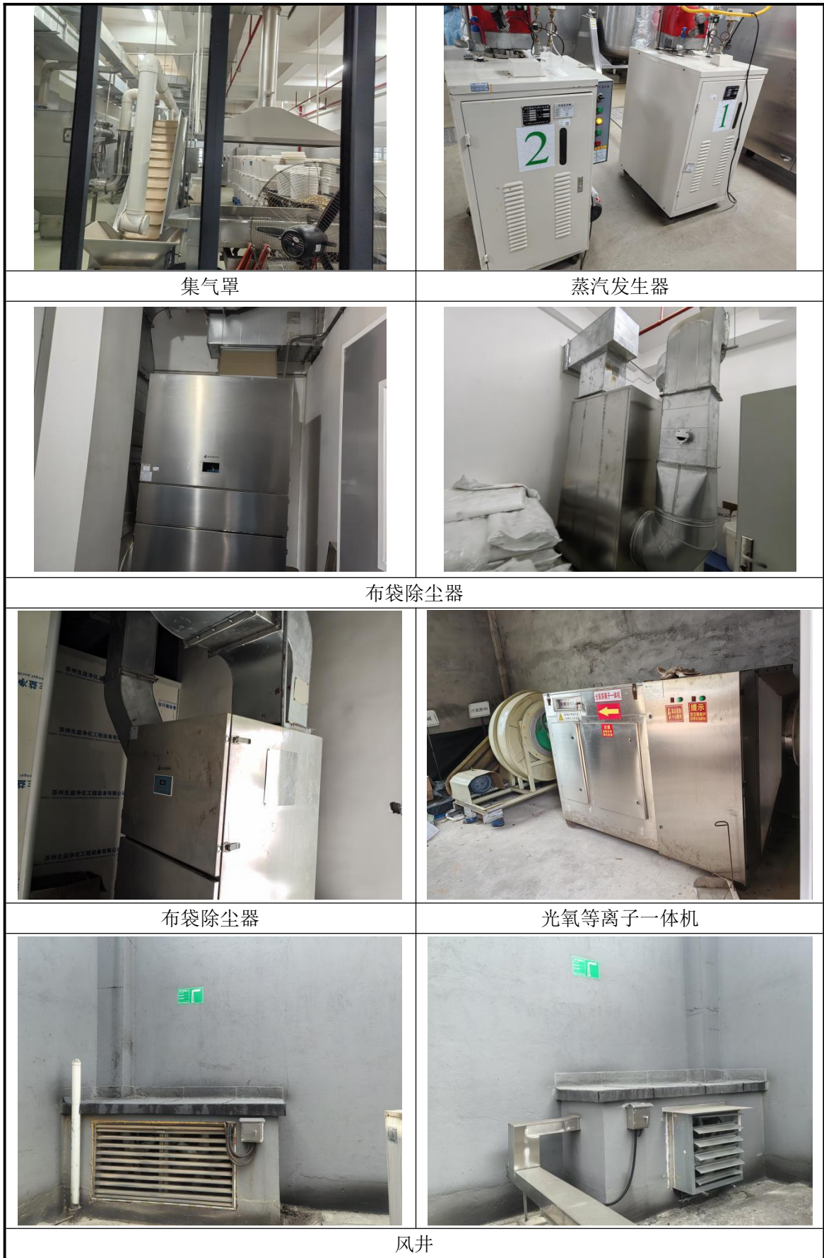
图 4.1-3 废气治理设施图
